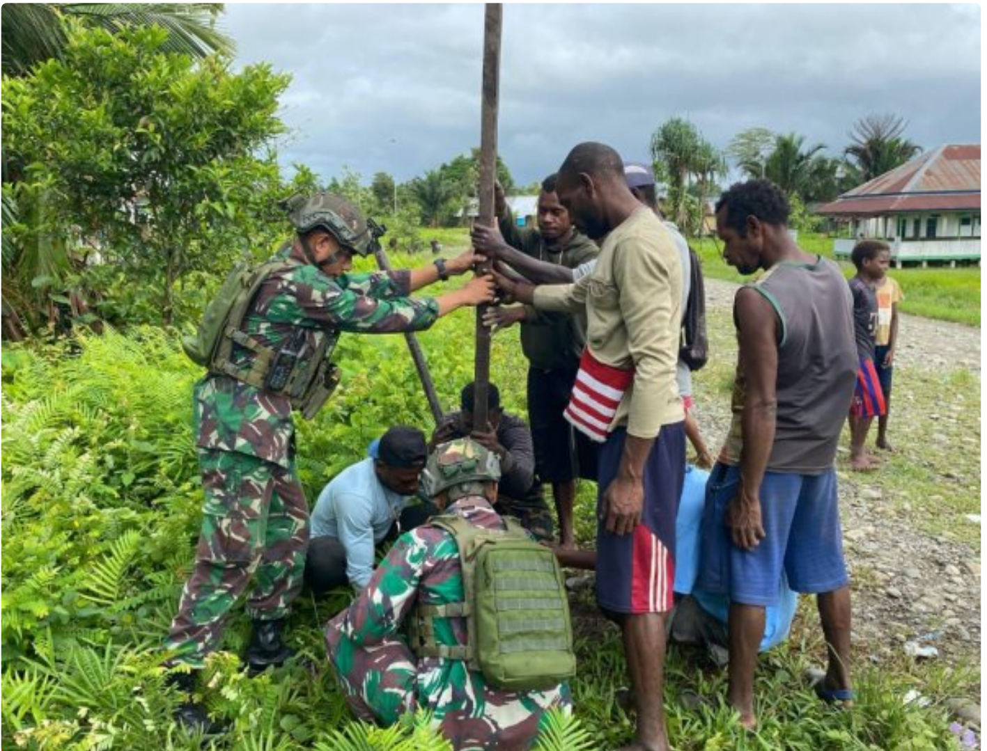
Foto: Satgas Pamtas Mobile RI-PNG Yonif 503/Mayangkara Koops Habema pasang lampu tenaga Surya (solar sel) di 50 titik sepanjang jalan utama di Distrik Krepkuri, Kecamatan Batas Batu, Kabupaten Nduga Papua. Selasa (08/10/2024).
